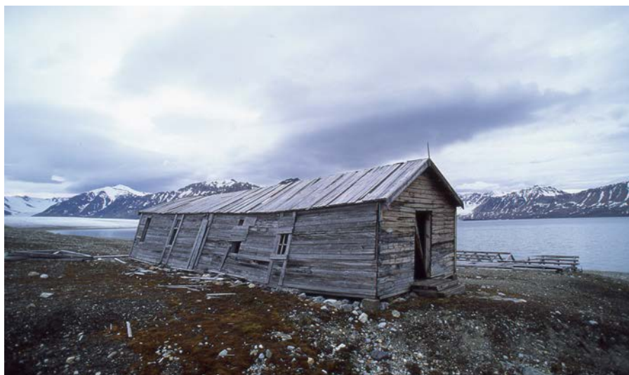
Fig. 3. Fortsatt står en av de opprinnelige fire bygningene i Iron Mountain Camp. Bygget er svært skjevt og må støttes opp for ikke å falle sammen. Rester av en lignende bygning ligger på bakken til høyre i bakgrunnen. (Foto: I. Gjertz 1996).
